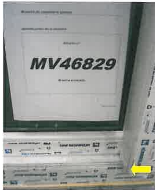
Zona filtración de agua
